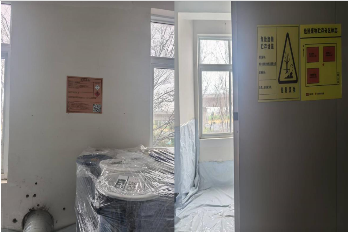
图3-7 危废暂存间现场照片图
