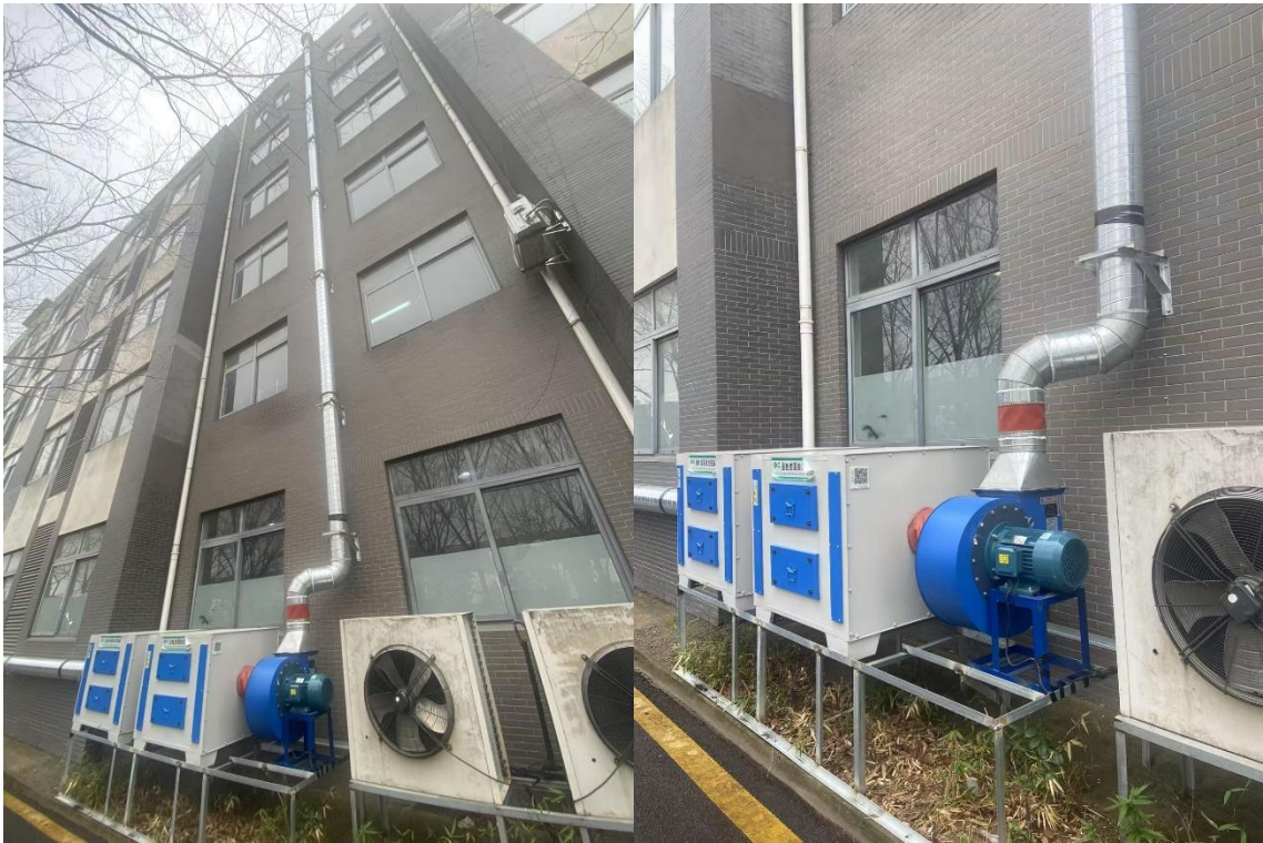
图3-5 废气处理装置现场图
